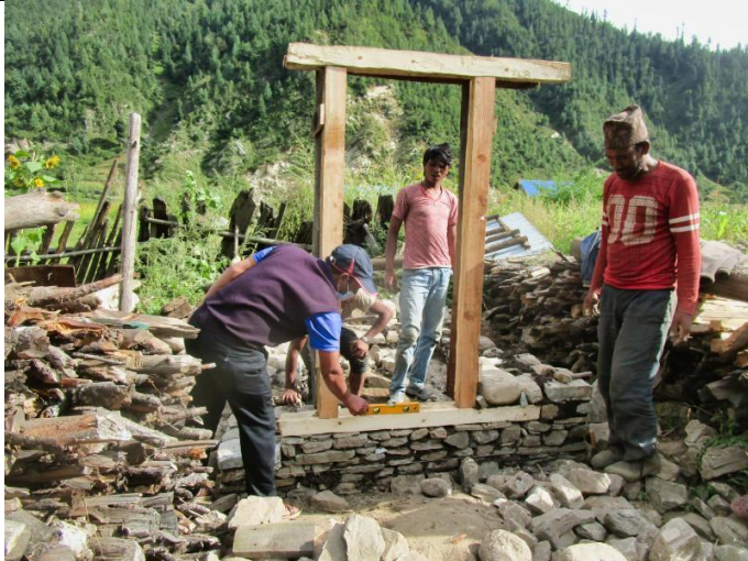
Bild 16: Die Mitarbeitenden von RIDS-Nepal stellen sicher, dass das Fundament der Toiletten-Tür präzise horizontal verläuft.
