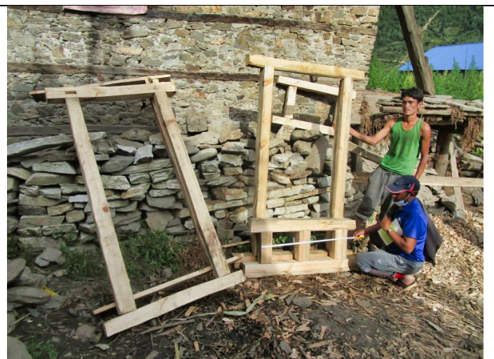
Bild 15: Dank Instruktion und Anlehre durch RIDS-Nepal Mitarbeitende kann jede Familie die Toiletten-Türrahmen und die Fenster selbst herstellen.
