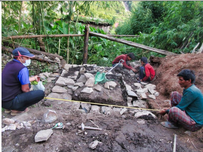
Bild 5: Während der Bauarbeiten überprüfen Mitarbeiter von RIDS-Nepal regelmässig den Fortschritt, um die Qualität der Toiletten sicherzustellen.
