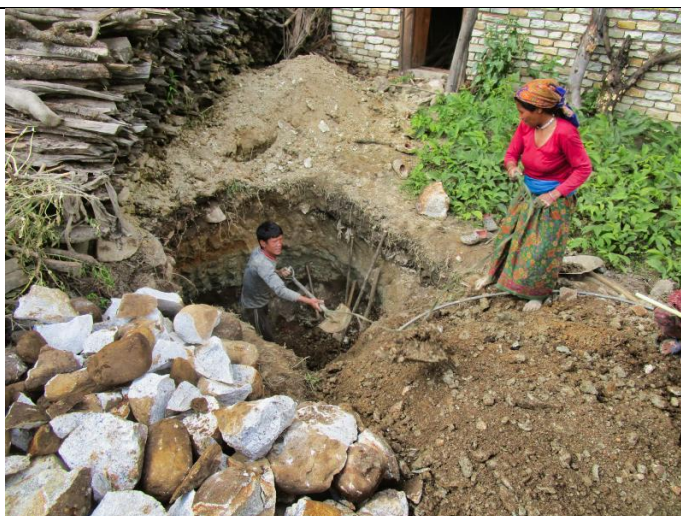
Bild 7: Eine der Hauptaufgaben für jede Familie ist das Ausheben der Klärgrube für die Toilette. Je nach Beschaffenheit des Untergrunds ist dies eine aufwändige Arbeit.
