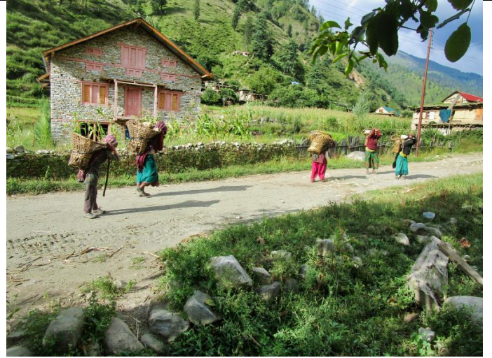
Bild 4: Vielfach sind es die Frauen, welche die schweren Steine für das jeweilige Toiletten-Gebäude und die Klärgrube aus dem nahe gelegenen Steinbruch ins Dorf tragen.
