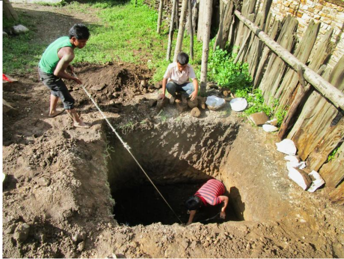
Bild 10: Die Klärgrube (etwa 2 m tief und 1,8 m breit) kann von einer von 5 - 6 köpfigen Familie bis zu 8 Jahre lang benutzt werden: Erst dann müssen die Rückstände entfernt als Dünger auf die Wiesen verteilt werden.
