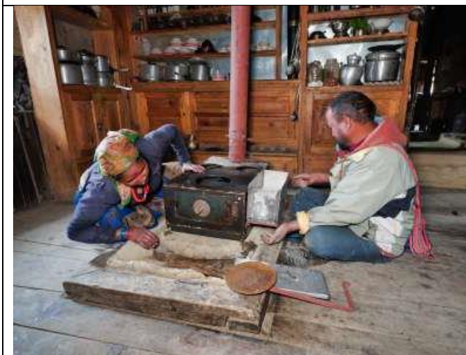
Ein RIDS-Nepal Mitarbeiter instruiert nach der Installation des rauchfreien Metallofens die Frau des Hauses.
