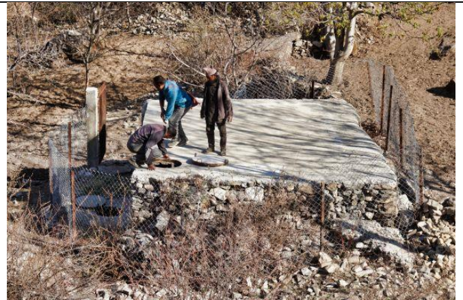
Vertreter von RIDS inspizieren mit dem Verwalter des Dorf-Trinkwassersystems den Wassertank auf Sauberkeit. Überprüft wird auch, ob die Quelle in der Trockenzeit über ausreichend Wasser verfügt.
