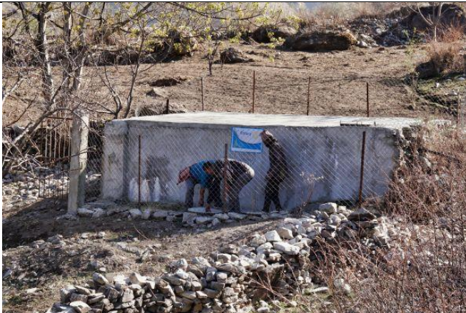
25'000 Liter Wassertank für das Dorf-Trinkwassersystem. An allen 15 Dorfbrunnen kann damit am Morgen und am Abend die maximale Wassermenge abgegeben werden.
