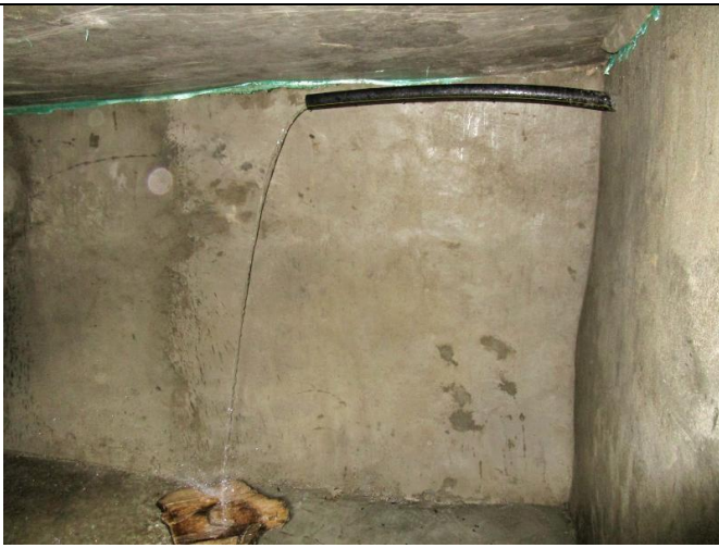
Bild 12: Der Fassungstank ist innen sorgfältig zementiert. Es dürfen keine Lecks entstehen, und das Wasser muss sauber bleiben. Es kommt durch die etwa 1200m lange, unterirdisch verlegte Polyethylen Leitung von der Quelle in den Tank.
