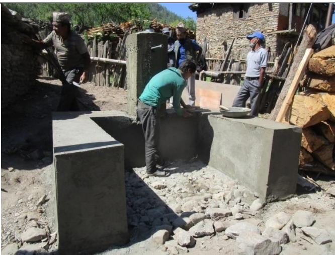
Bild 20: Beispiel einer Zapfstelle, die mittels einer 1:1 Zement-Sand Mischung ihre feine Oberfläche erhält. Der schützende Überzug garantiert Wasserdichtheit und eine lange Lebensdauer.
