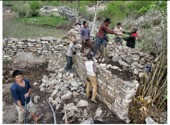
Bild 7: Vorbereitungs- und Bauarbeiten für den grossen Wasserfassungstank oberhalb des Dorfes, der zur Speicherung von bis zu 25'000 Liter Trinkwasser dient.
