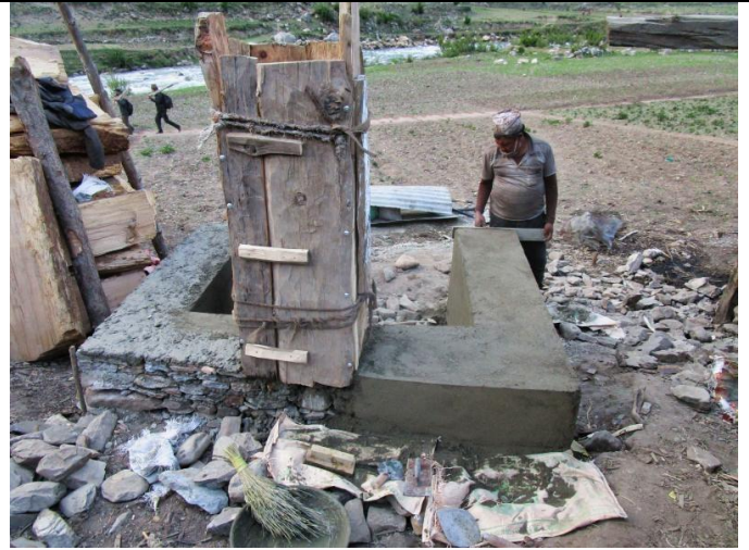
Bild 19: Die Steine für die 15 Zapfstellen werden von den Bewohnern von Pere gesammelt und bearbeitet. Die anschließende Zementierung mit lokal gesammeltem Sand und Steinen, stellt Struktur und Stabilität derselben sicher.
