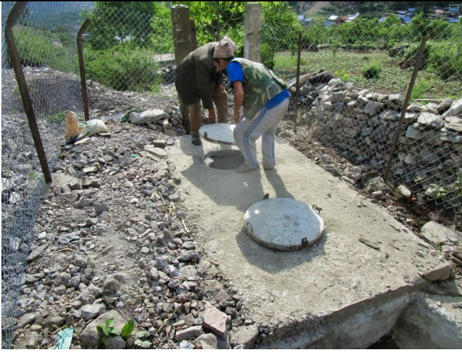
Bild 6: Das Wasser wird im Sedimentationstank gesammelt. Das betonierte Dach verfügt über Einstiegsmöglichkeiten für Kontroll- und Reinigungsarbeiten.
