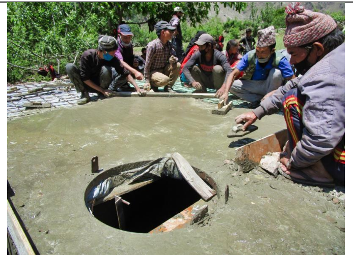
Bild 11: Einstiegsmöglichkeit in den Wasserfassungstank. Wie beim Sedimentationstank (vgl. Bild 6) können damit auch beim Fassungstank periodische Kontroll- und Reinigungsarbeiten durchgeführt werden.
