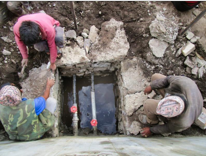
Bild 14: Am Fassungstank sind vier Metallrohre angebracht. Je ein Rohr für den Wasserzufluss, für die unterirdische Verteilung zu den 15 Zapfstellen, für den Überlauf sowie für die Belüftung. Das Bild zeigt den Zugriff für Unterhaltsarbeiten.
