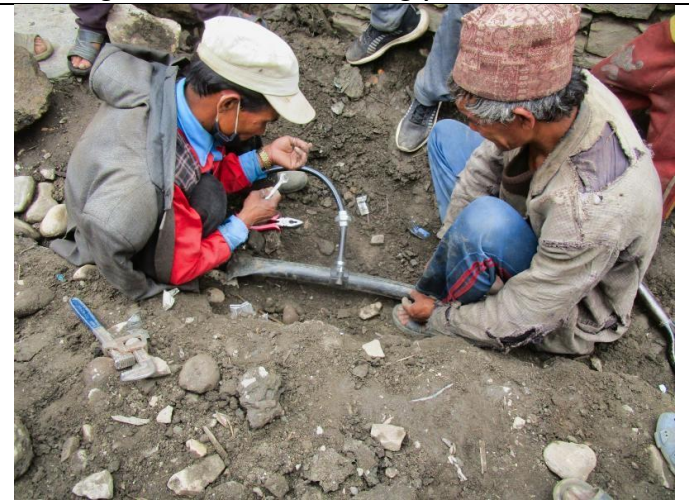
Bild 15: Die Versorgung der 15 Zapfstellen erfolgt durch eine High-Density-Polyethylen (HDPE) Leitung, die an das entsprechende Metallrohr des Fassungstanks angeschlossen ist. Die Feinverteilung im Dorf erfolgt mit dünneren HDPE Leitungen.
